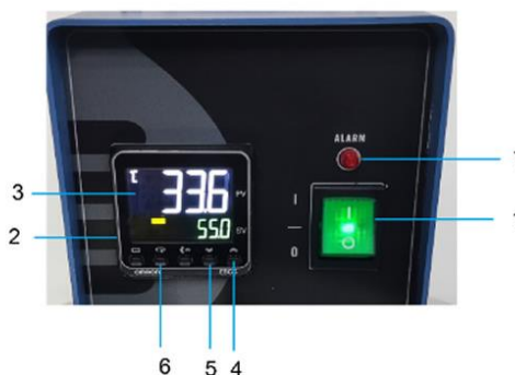
Fig 1 – Pannello di controllo e display
